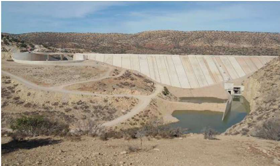
Figure 17 : exemple d'un barrage en enrochements à masque amont en béton (Barrage Zerrar)
