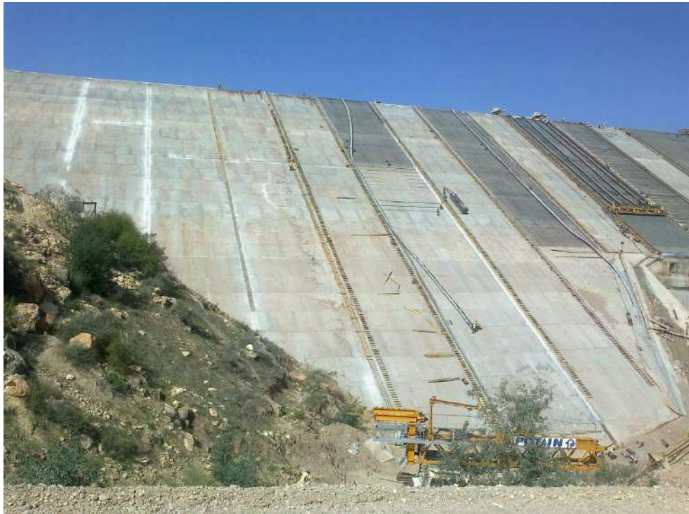
Figure 19: vue de l'amont du masque amont en béton du barrage Zerrar en cours
